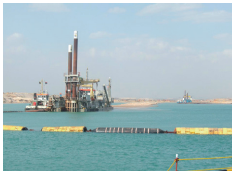
第2スエズ運河建設のための掘削作業中。複数の重機や船が投入されている。第2スエズ運河はここから始まる。=2015年1月14日、南龍太郎撮影 Drilling operations underway for construction of the second Suez Canal. Multiple heavy equipment and vessels are mobilized. The second Suez Canal starts from the spot captured by this photo.=Photo by Ryutaro Minami on January 14, 2015
